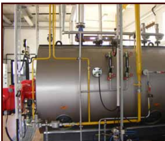
New furnaces in Kecskemét
